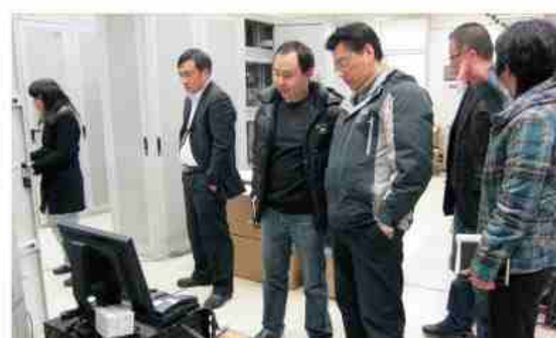
重庆多媒体调度软交换组网测试现场
